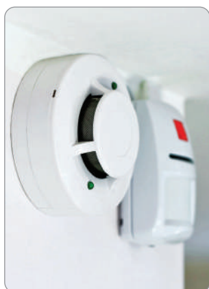
Системы противопожарной защиты
